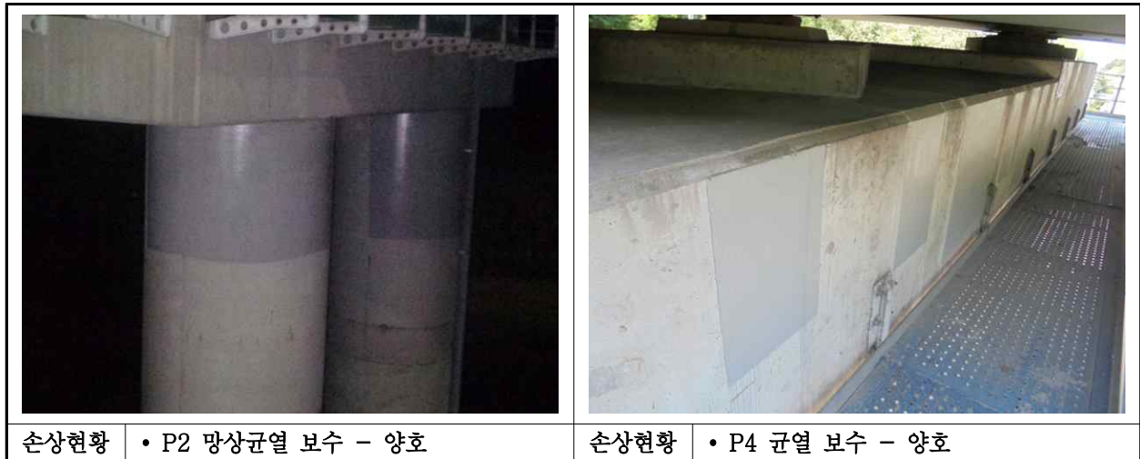
【사진 1.3.11】 교각 손상현황(계속)
